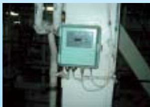
油分監視装置
