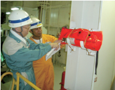
検船活動中の消防設備の点検
